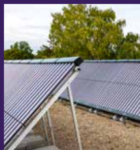
Mit Photovoltaik fangen die Dächer der Wasserstraße die Sonne ein.
