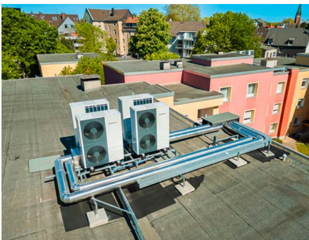
Wärmepumpen am Kalsbusch
